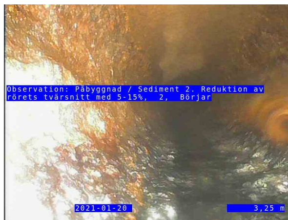
1_0004.jpeg, 00:01:46, 3.25m Påbyggnad / Sediment 2. Reduktion av rörets tvärsnitt med 5-15%, 2, Börjar
