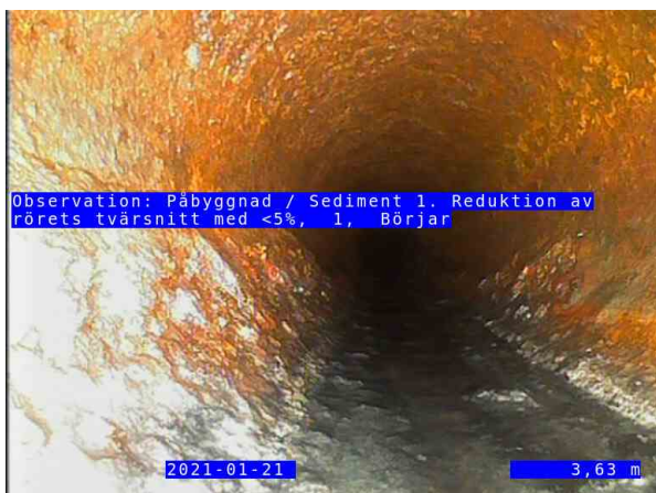
4_0001.jpeg, 00:00:51, 3.63m Påbyggnad / Sediment 1. Reduktion av rörets tvärsnitt med <5%, 1, Börjar
