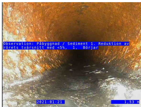
5_0003.jpeg, 00:07:31, 1.53m Påbyggnad / Sediment 1. Reduktion av rörets tvärsnitt med <5%, 1, Börjar
