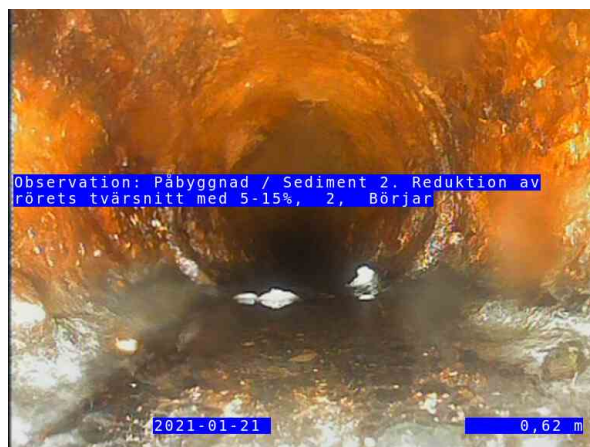
1_0012.jpeg, 00:11:19, 0.62m Påbyggnad / Sediment 2. Reduktion av rörets tvärsnitt med 5-15%, 2, Börjar
